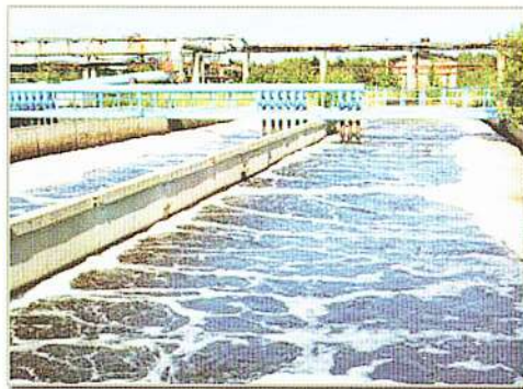
บ่อบำบัดน้ำเสีย
