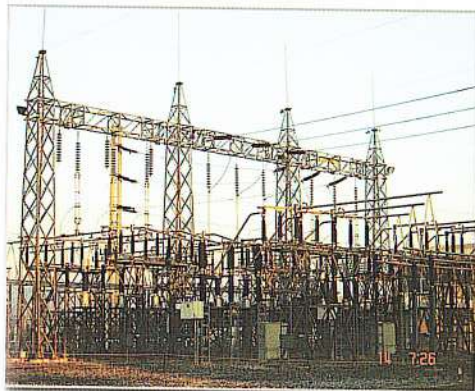
ลานไฟฟ้า
